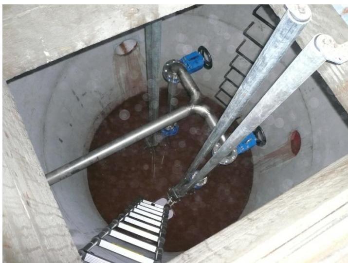
obrázek č.3 - Čerpací stanice na kanalizaci Velké Poříčí - VAK Náchod, a.s.
