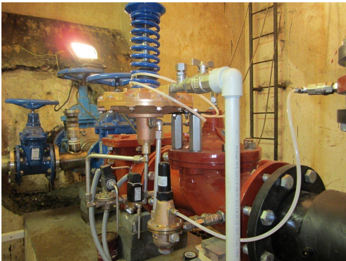
Obrázek č. 9 – Pohled na regulační ventil v armaturní komoře VDJ Nemocnice, Náchod
