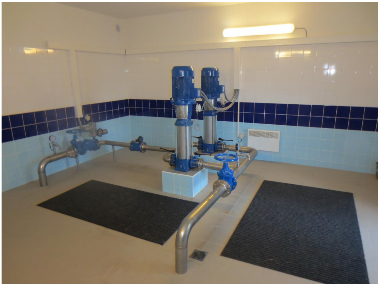
obrázek č.3 Pohled na armaturní komoru- ČS Nové Město nad Metují
