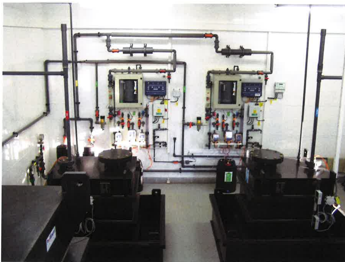
Obrázek 2 nové dávkovací zařízení chlordioxidu ČS Vysoká Srbská
