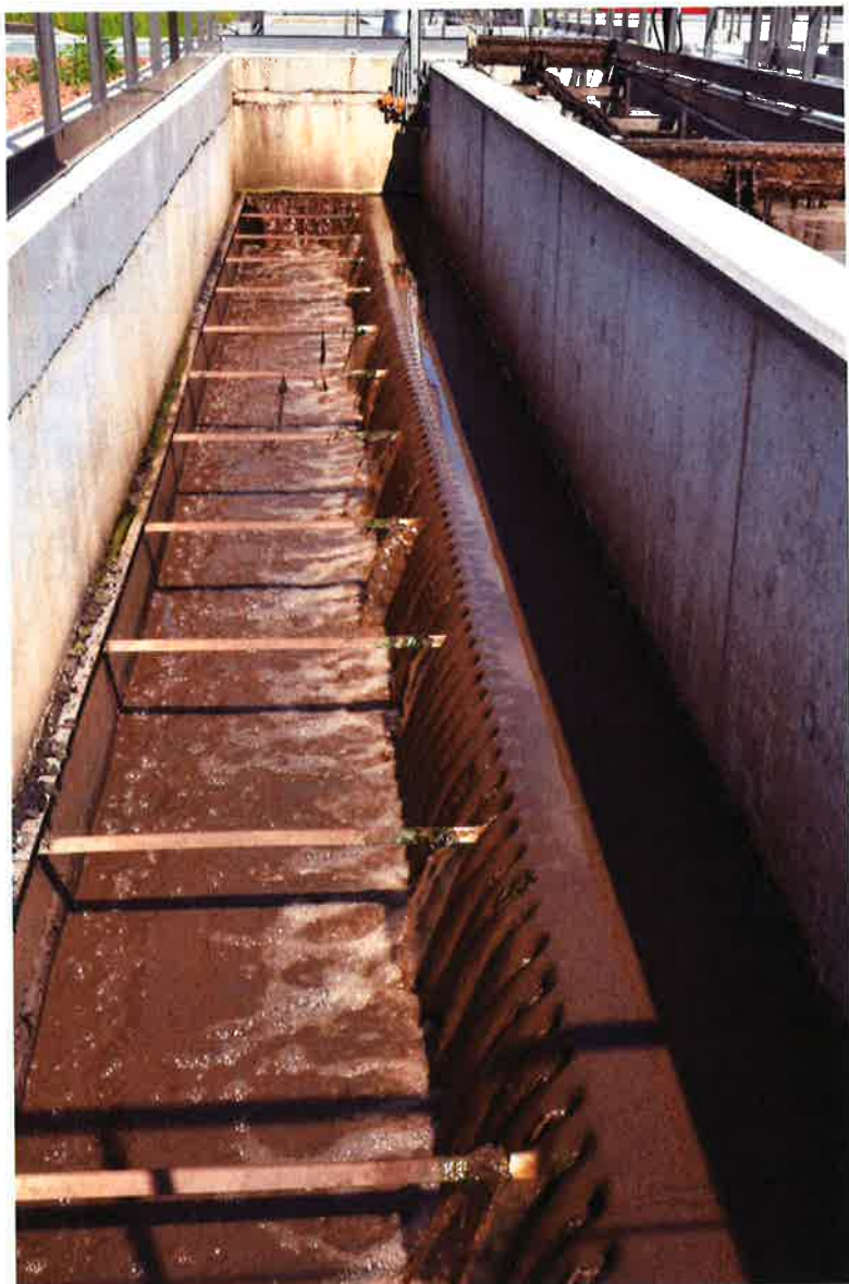
Obrázek 5 odtok aktivční směsi na dosazovací nádrže ČOV Náchod
