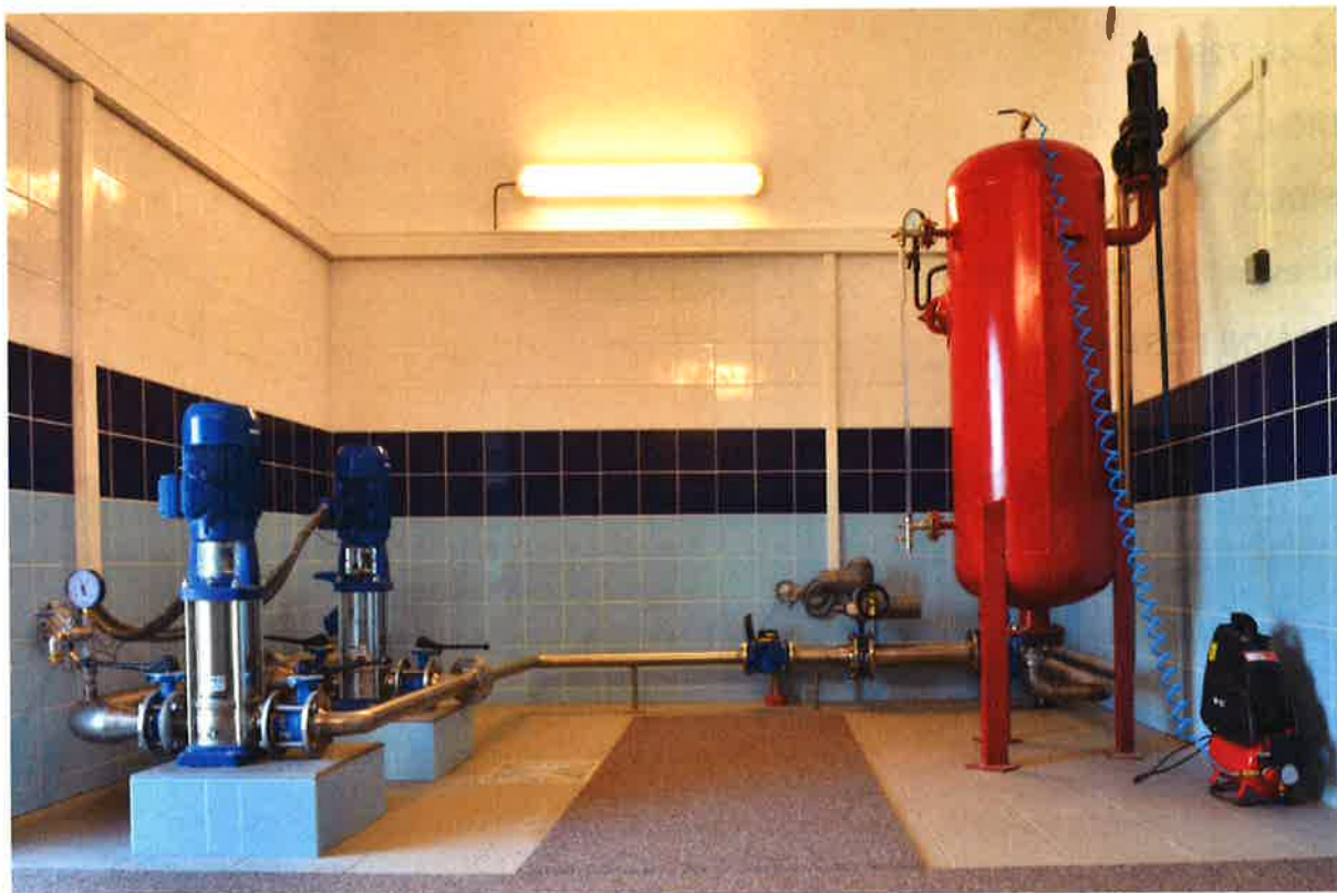
Obrázek 1 armaturní komora ČS SPY - Nové Město nad Metují
