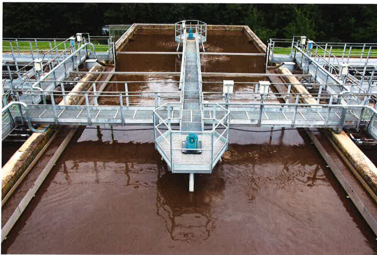
Obrázek 6 – denitrifikační nádrž - ČOV Nové Město nad Metují.
